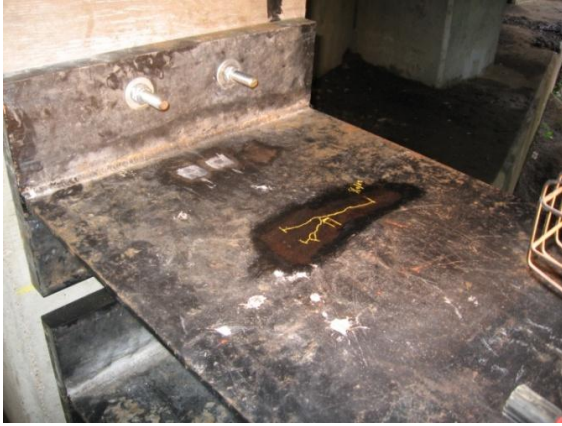
a. Top web plate cracking
