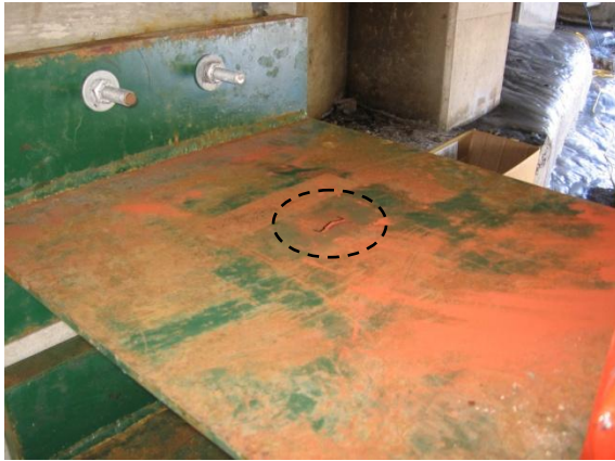
b. Top Web-Plate Cracking
